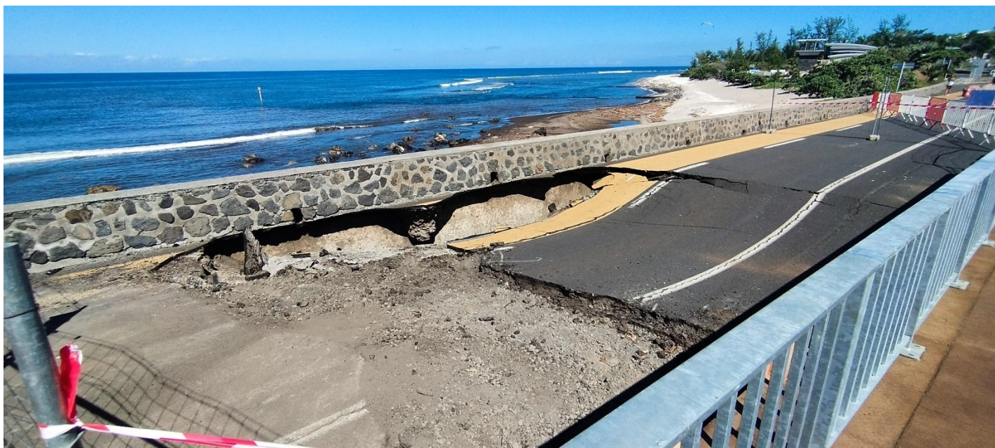
Photo 65 (B Cauvin GIP RNMR) 04 mars 2025 : chaussée du pont côtier de la ravine des Colimaçons à Saint Leu partiellement écroulée lors du passage du cyclone Garance, en arrière-plan, partie sud (étudiée par deux radiales) de la plateforme récifale de la pointe des châteaux, les panaches turbides sont peu observables 4 jours après le passage du cyclone Garance.
